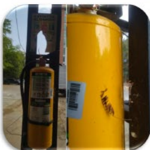
7. Identificación de extintor en malas condiciones y extintor sucio
